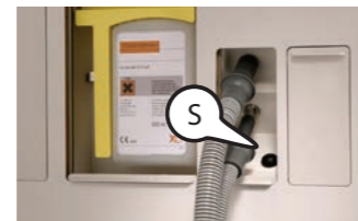
Tubos de aspiración conectados a los manguitos de desinfección.
