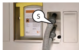
Placer les tuyaux d'aspiration sur les mamelons de désinfection.
