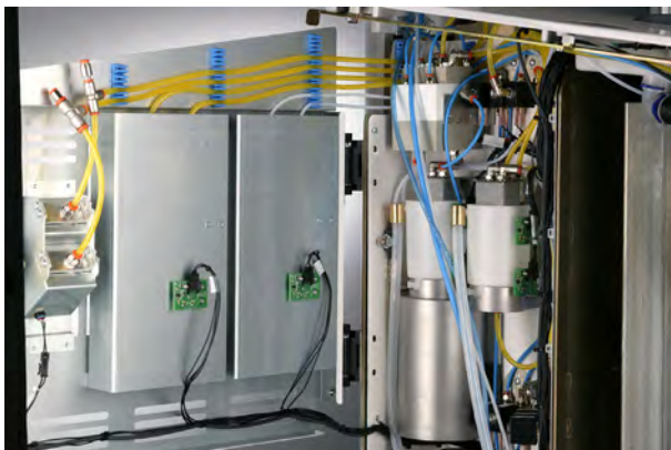
Figure 27 Accès au séparateur d'amalgame
